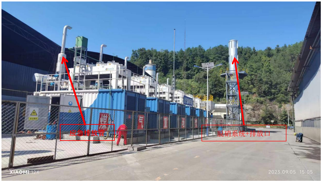
煤气发电系统废气处理及排放口
