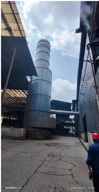
焙烧废气双碱法脱硫+排放口
