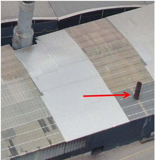
焙烧原料排气筒
