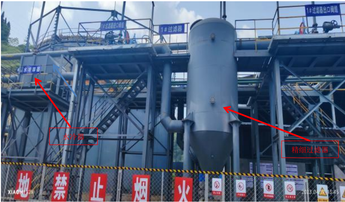
煤气净化系统（水冷器+精细过滤器）
