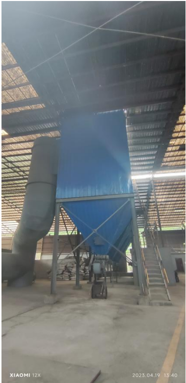
焙烧废气布袋除尘器
