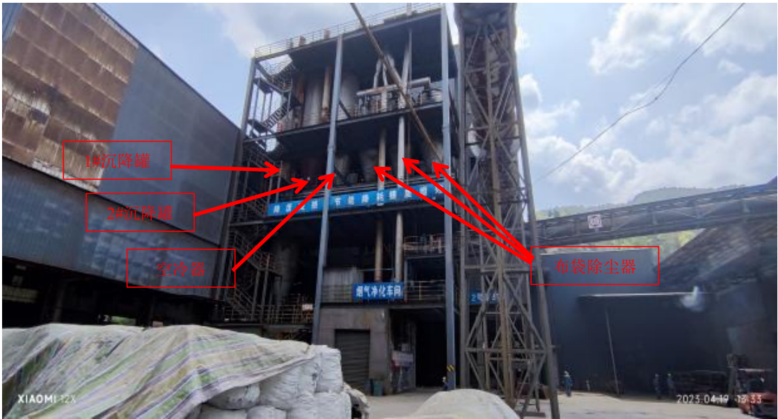
煤气净化系统（沉降罐+空冷器+布袋除尘器）
